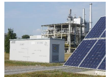
Prototyp eines Lithium-Ionen-Großspeichers im Energy Lab 2.0 (Foto: Batterietechnikum, KIT)
