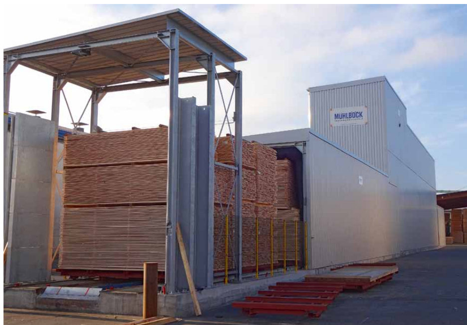
Dem Kanaltrockner wird taktweise immer nur ein Stapel zugeführt: Dies glättet den Energieverbrauch und die Abnahme beim Heizkessel
